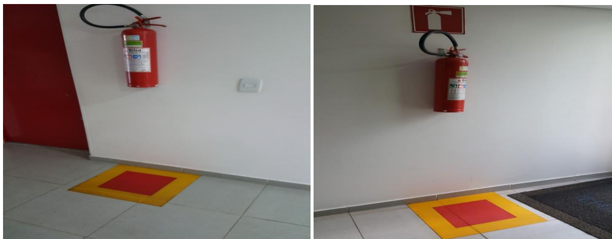
Figura 65-3.1 Demarcação de todos extintores de incêndio das garagens.
